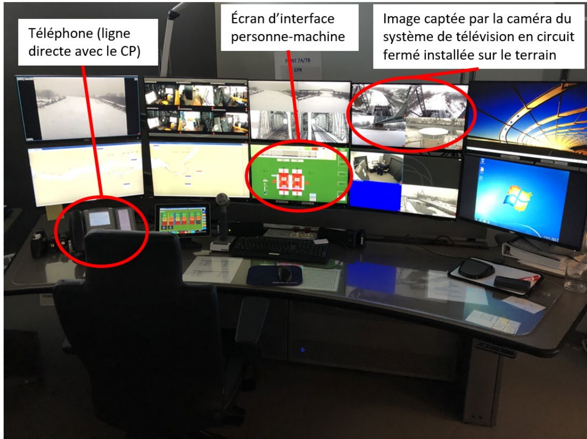
Figure 4. Poste de travail d'un opérateur des ponts de la Voie maritime (Source : Corporation de gestion de la Voie maritime du Saint-Laurent)
