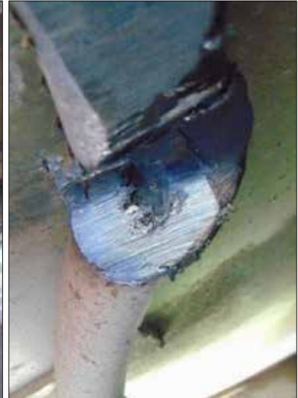
Figure 5. Gros plan des marques de brûlure/meulage sur la conduite générale
