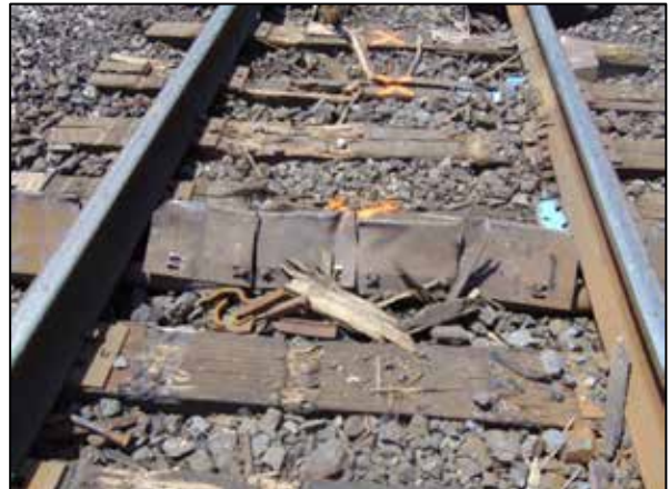
Figure 10. Marques d'impact de roue sur les palettes du détecteur de pièces traînantes (point milliaire 19,51)
