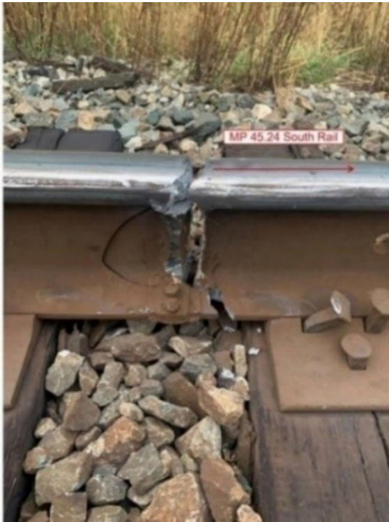
Figure 9. Rail sud au point milliaire 45,24, montrant que l'âme et le patin du rail sont rompus (Source : Canadien National)
