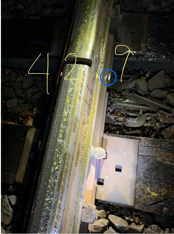
Figure 6. État de la voie au point milliaire 42,9, y compris une marque d'impact du côté intérieur de l'éclisse (encerclée), une marque brillante sur le patin du rail et des rognures d'acier du côté intérieur (Source : Canadien Pacifique)
