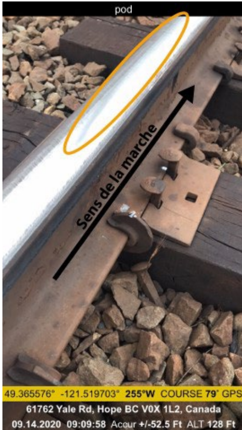
Figure 7. Marque sur le dessus du rail sud, à quelques traverses à l'est du point milliaire 44,4 (Source : Canadien National, avec annotations du BST)
