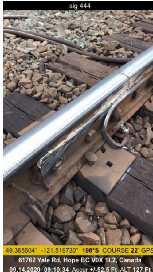
Figure 8. Boulon cisailé et éclisse isolante endommagée au point milliaire 44,4 du rail sud (Source : Canadien National)
