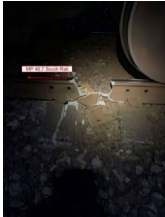
Figure 10. Rail sud rompu au point milliaire 46,7, montrant une rupture mesurant environ 4 à 6 pouces (Source : Canadien National)
