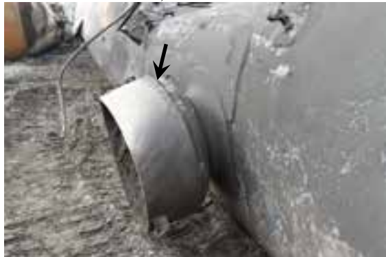
(f) Détail de la paroi d'enceinte endommagée (flèche)
