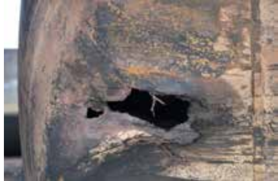
(d) Gros plan de la rainure et de la perforation montrées en (c) (photo du Projet de sécurité RSI-AAR)
