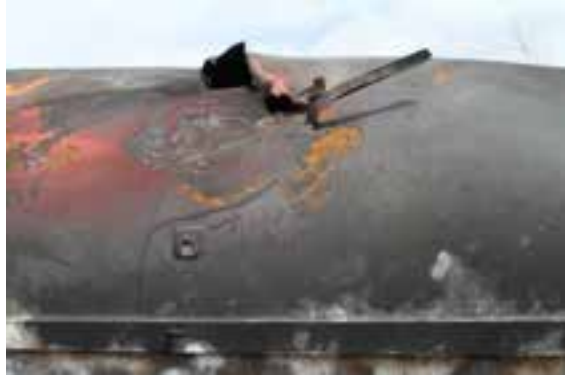
(d) Perforation de la coque
