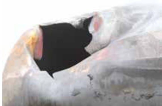
(d) Perforation dans la coque
