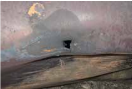
(e) Gros plan de la région repérée par une flèche (d) montrant une bosselure longitudinale et une petite perforation dans la coque (photo du Projet de sécurité ferroviaire RSI-AAR)
