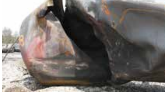
(d) Détail de la grande rupture de coque
