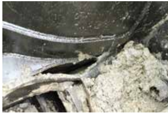
(b) Gros plan des soudures brisées de la longrine tronquée au bout B
