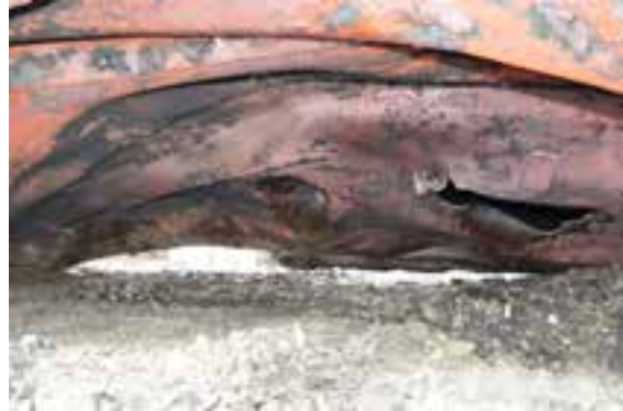
(d) Détail d'une perforation dans la coque (photo du Projet de sécurité RSI-AAR)
