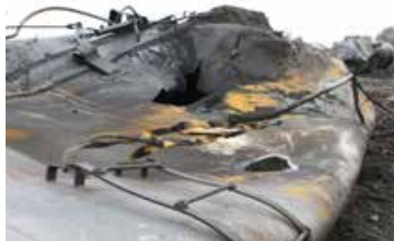
(d) Perforation dans le bas de la coque
