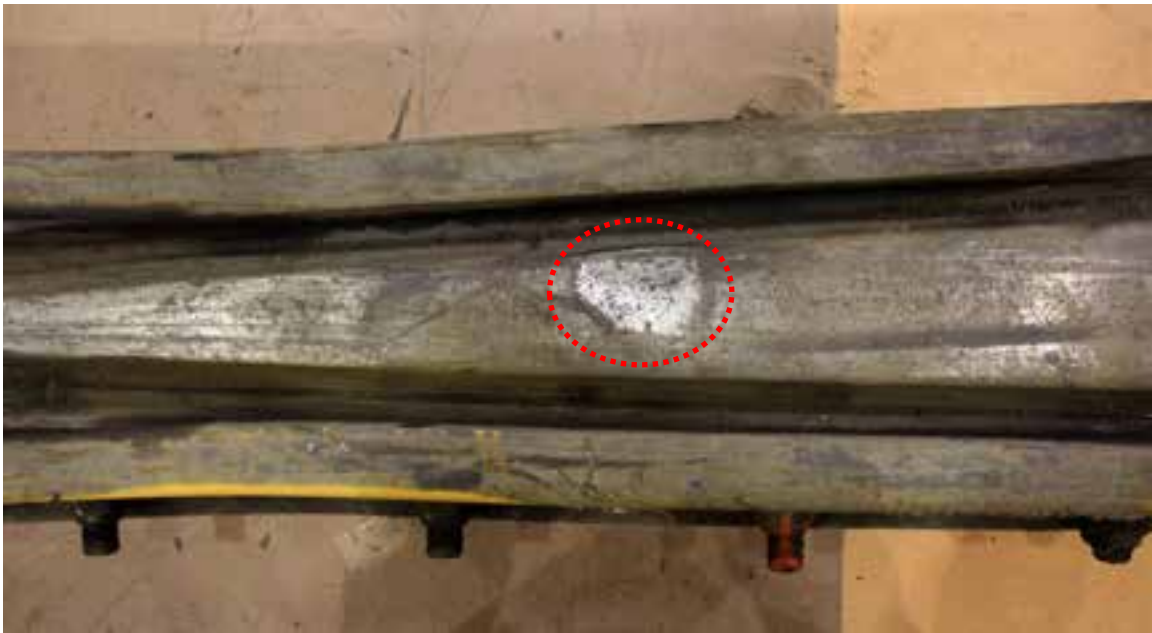
Figure 7 : Soudure de réparation sur le cœur à quelque 3,5 pieds de l'extrémité de la pointe
