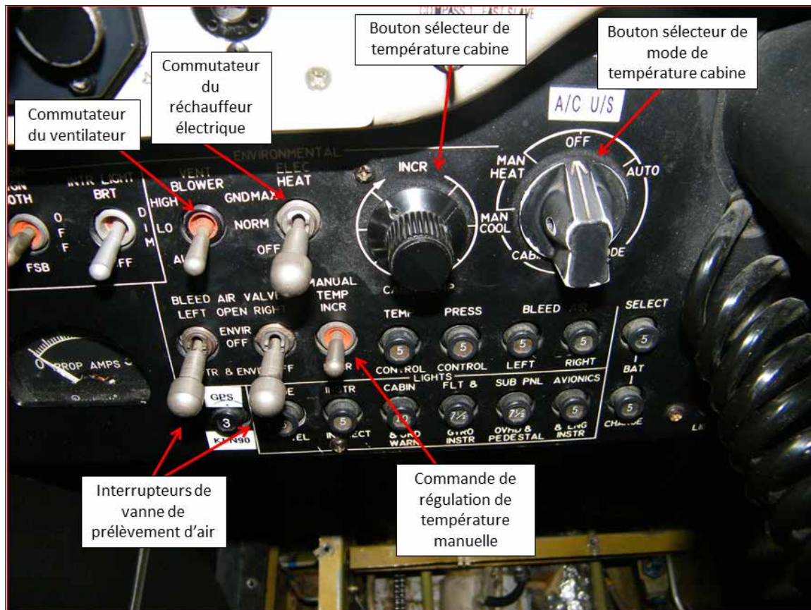
Photo 2. Tableau de commande du système de ventilation
