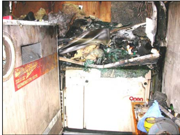
Photo 3. Étagère effondrée où étaient entreposés des produits inflammables dans la salle des machines
