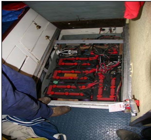
Photo 8. Compartiment sous le plancher renfermant les batteries principales d'alimentation des appareils domestiques et électroniques
