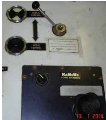
Photo 5. Emplacement de la note sur la machine
