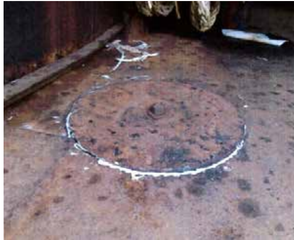
Photo 3. Joint d'étanchéité en silicone sur un des 26 panneaux d'écouille
