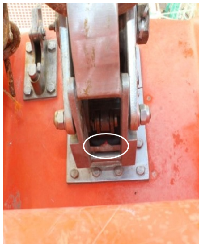
Figure 10. Croc de dégagement avant de l'embarcation de sauvetage en position fermée, avec indicateurs de position de verrouillage du mécanisme de largage sous tension/hors tension alignés (cercle blanc). La vue de l'opérateur serait obstruée par l'aménagement du pont. (Source : BST)
