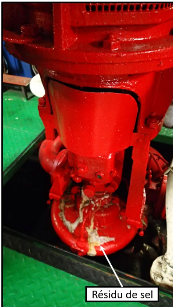
Figure G12. Résidus de sel issus d'un fouloir fuyant sur la pompe d'incendie d'urgence (Source : BST)
