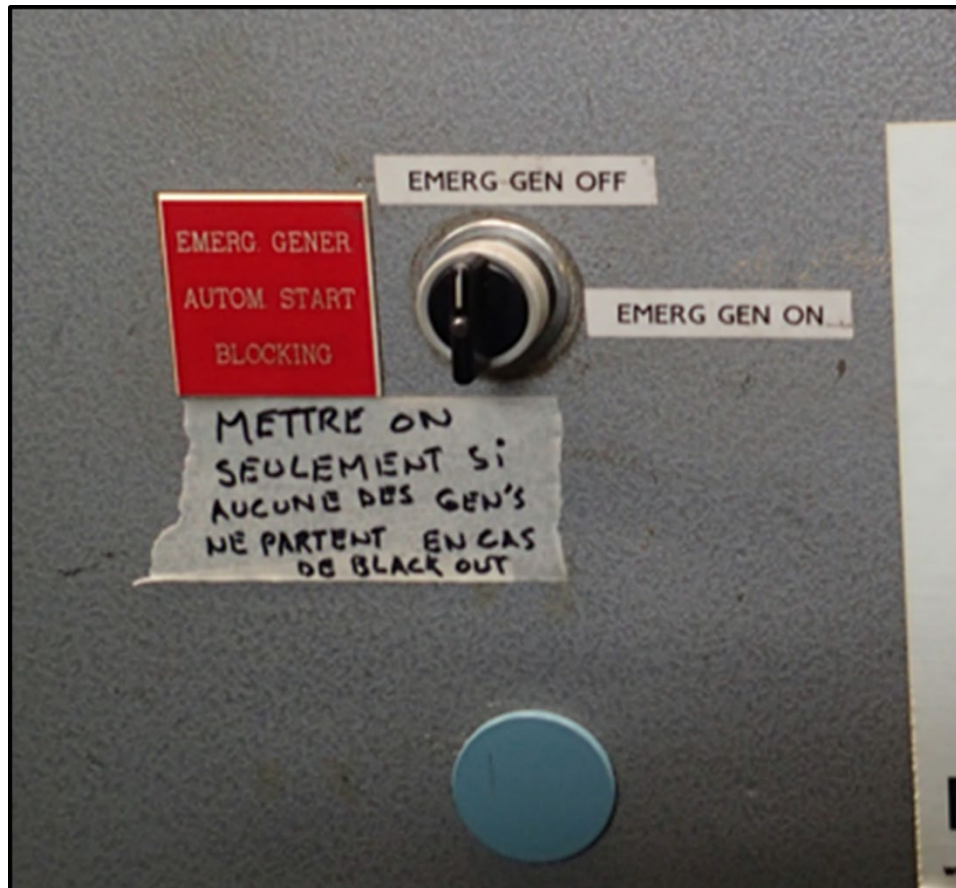
Figure 8. Interrupteur du groupe électrogène de secours (Source : BST)
