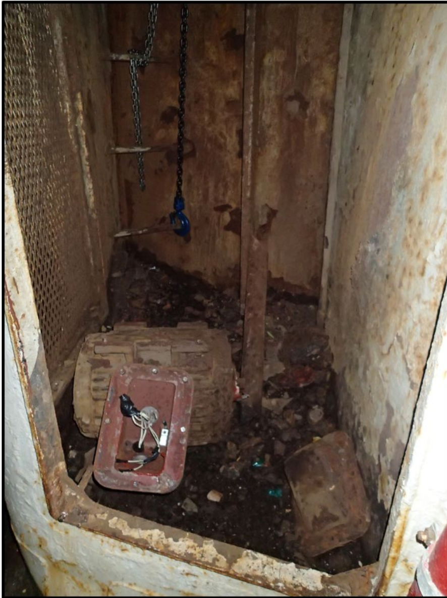
Figure G31. Ventilateur d'aspiration défectueux (Source : BST)
