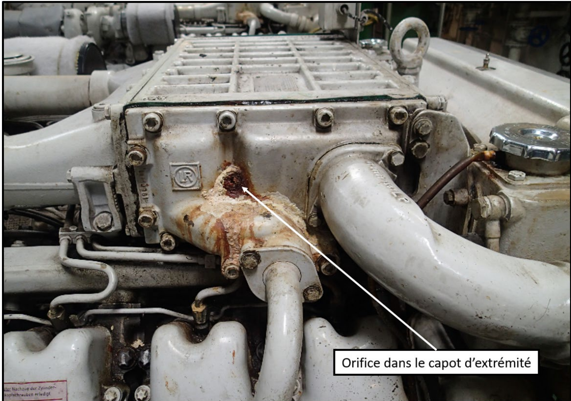
Figure G23. Perforation dans le capot d'extrémité d'un refroidisseur intermédiaire de l'un des moteurs diesels auxiliaires (Source : BST)
