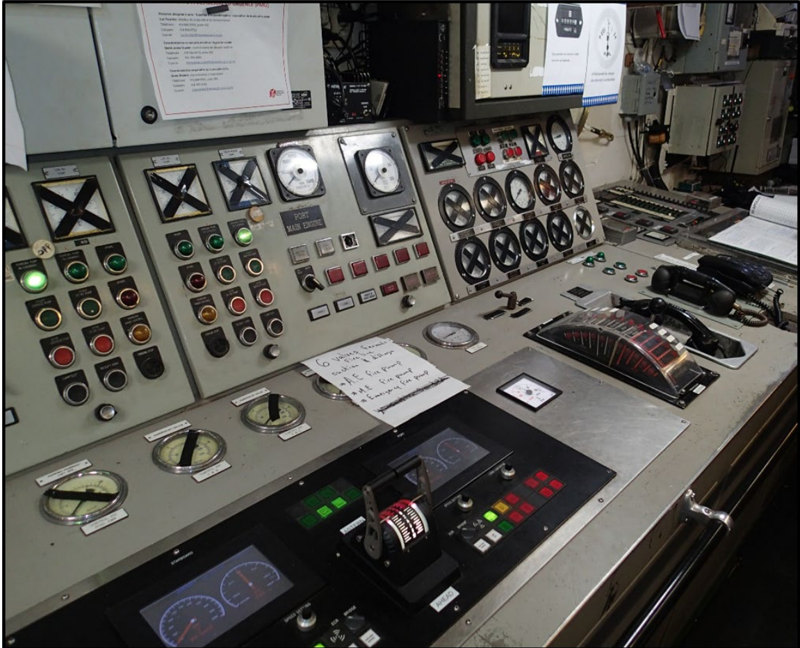
Figure G24. Interrupteurs et voyants inutiles dans la salle de commande des machines (Source : BST)
