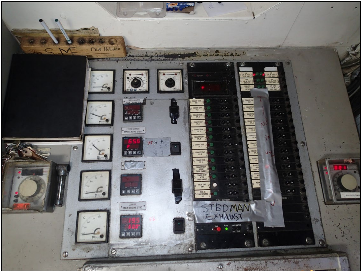
Figure G25. Interrupteurs et voyants actifs, sous du ruban à conduits (Source : BST)
