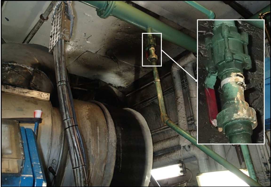
Figure G20. Résidus de sel autour d'une réparation effectuée au moyen d'un placard à joint plastique sur le collecteur d'incendie (Source : BST)
