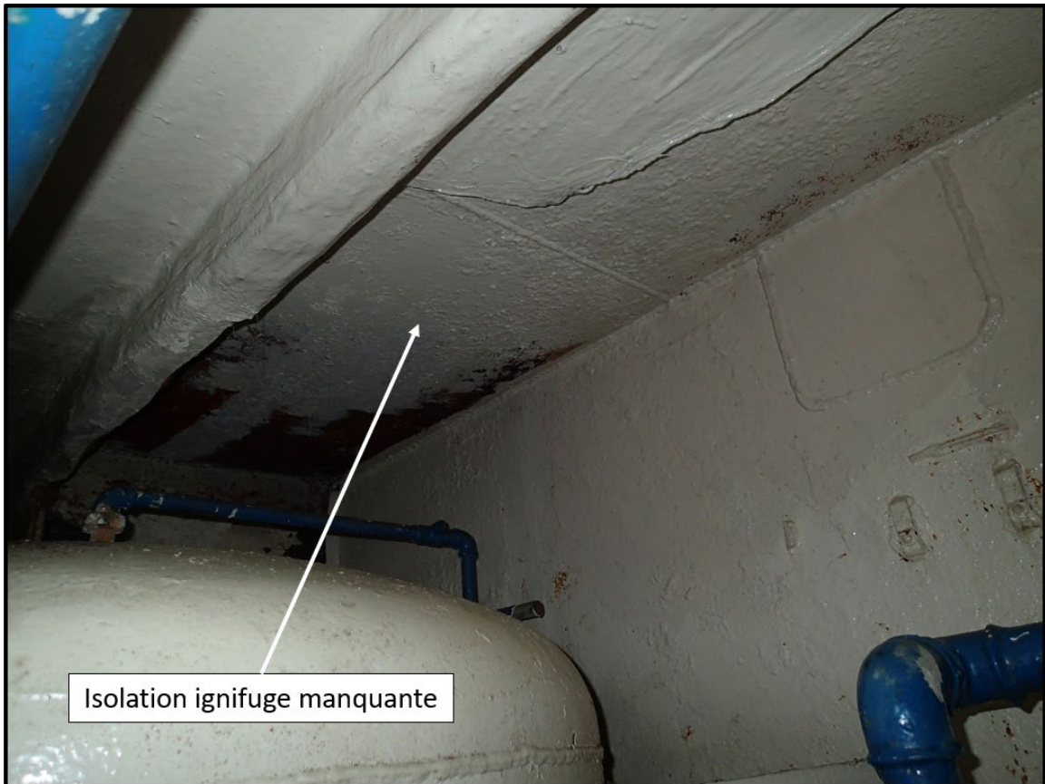
Figure G13. Manque d'isolation ignifuge dans la salle des machines (Source : BST)
