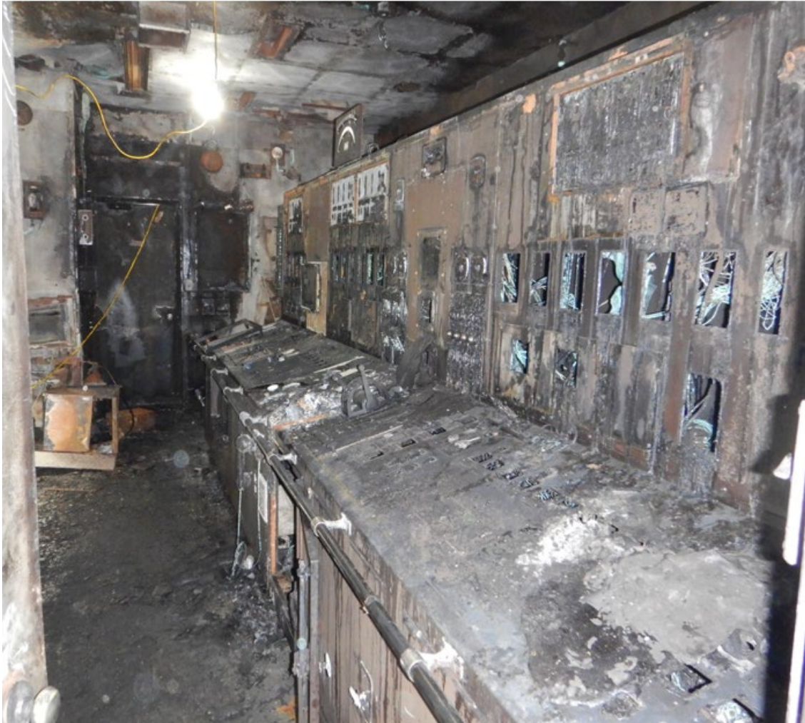
Figure 11. Consoles de la salle de commande des machines endommagées par le feu (Source : BST)
