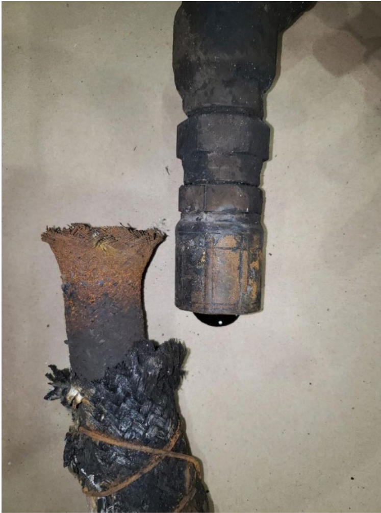
Figure 17. Canalisation de carburant alignée pour montrer la rupture à la sertissure (Source : BST)
