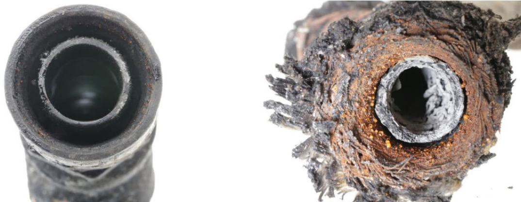
Figure 18. Côté de la sertissure de la rupture (à gauche) et côté du tuyau souple de la rupture (à droite) (Source : BST)
