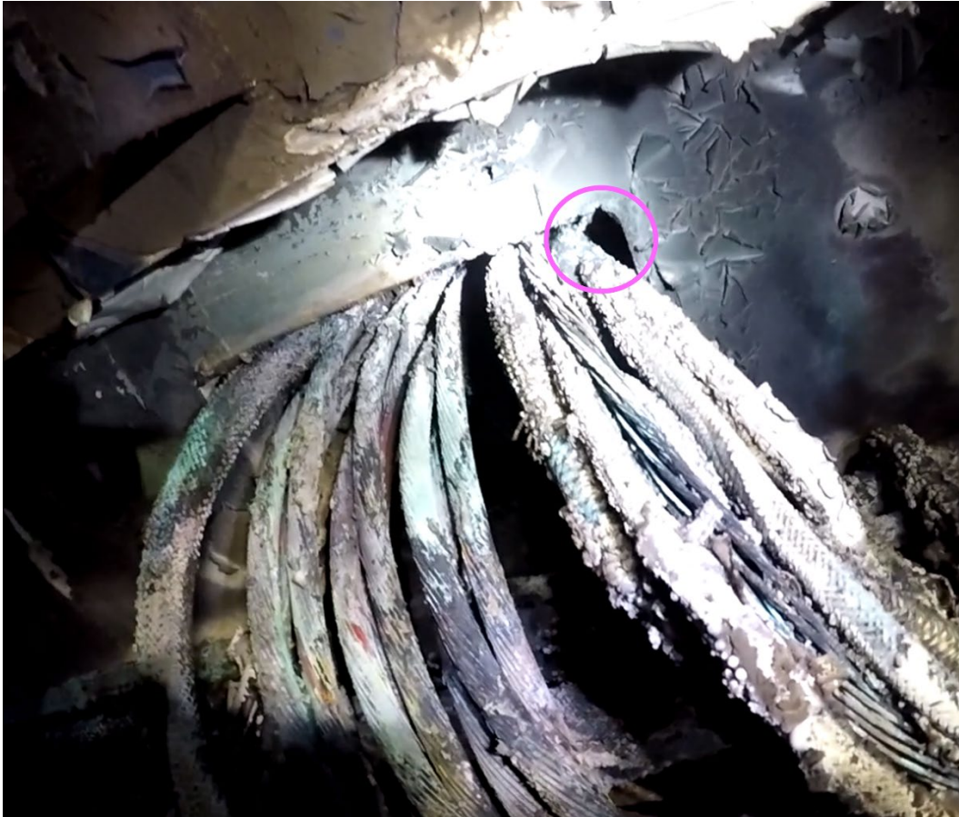
Figure 19. Traversée de pont non scellée (encerclée) (Source : BST)
