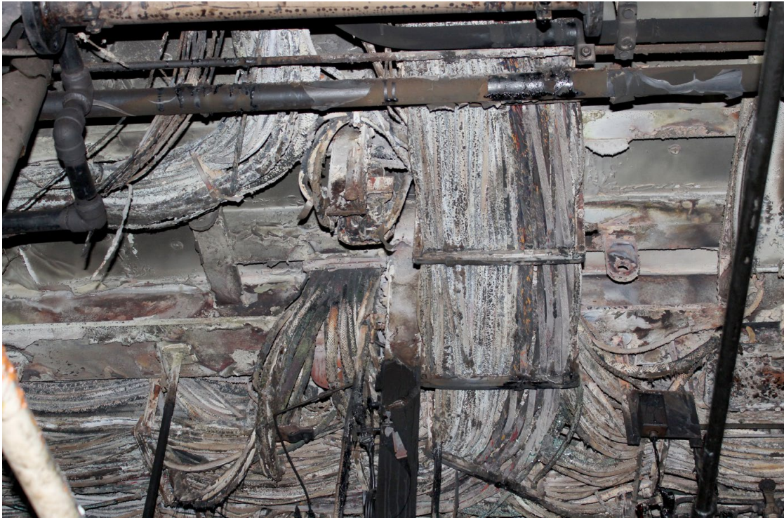
Figure 10. Câbles électriques brûlés courant sous le pont plateforme de 24 pieds (Source : BST)
