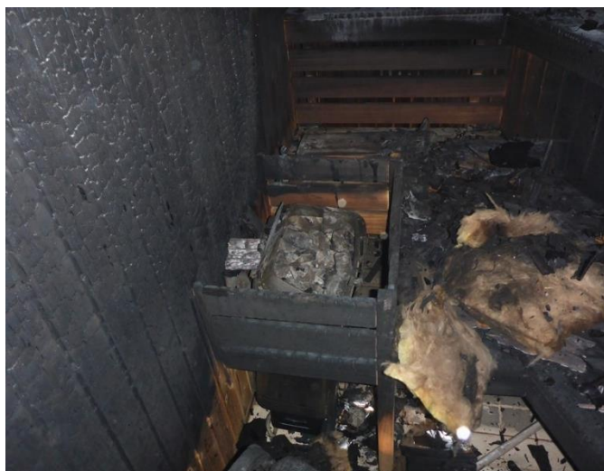
Figure 5. Dommages à l'intérieur du sauna, y compris le radiateur électrique (Source : BST)
