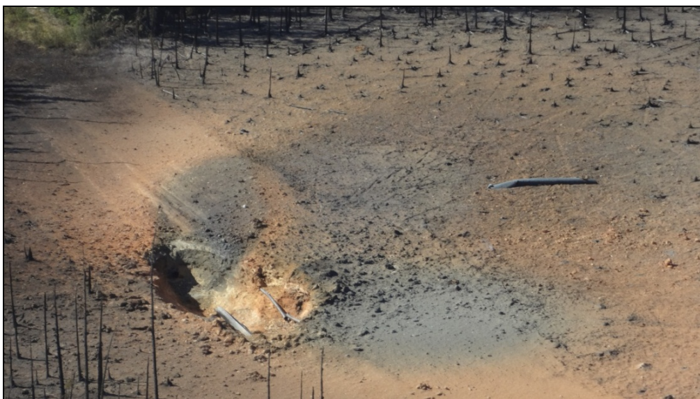
Photo 2. Lieu de l'accident : cratère et section de conduite éjectée
