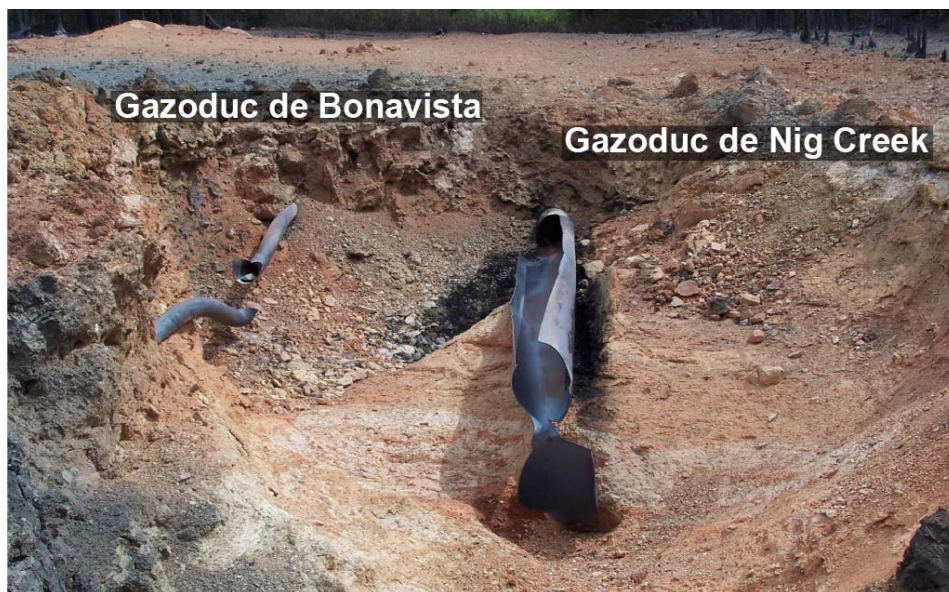
Photo 3. Gazoducs de Bonavista et de Nig Creek à l'intérieur du cratère
