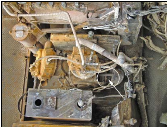
Photo 5. Cylindre de compression brisé dans le compresseur à deux étages
