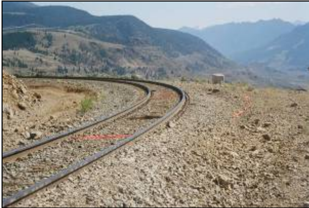
Photo 3. Point de déraillement de la locomotive
