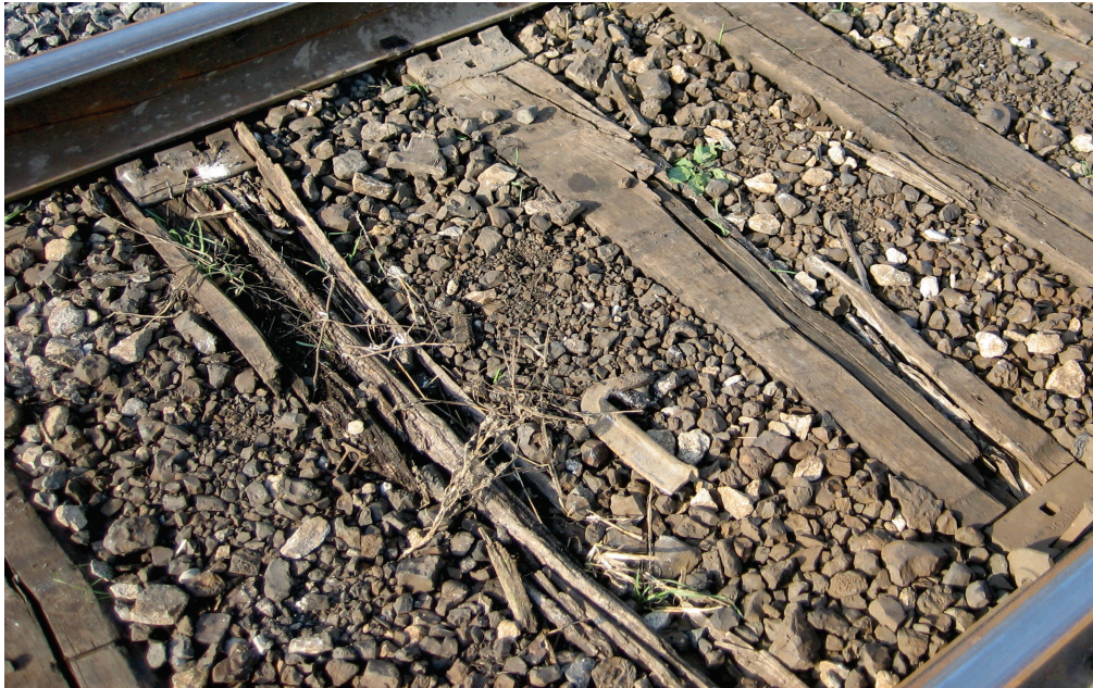
Photo 3. État des traverses dans le secteur du déraillement
