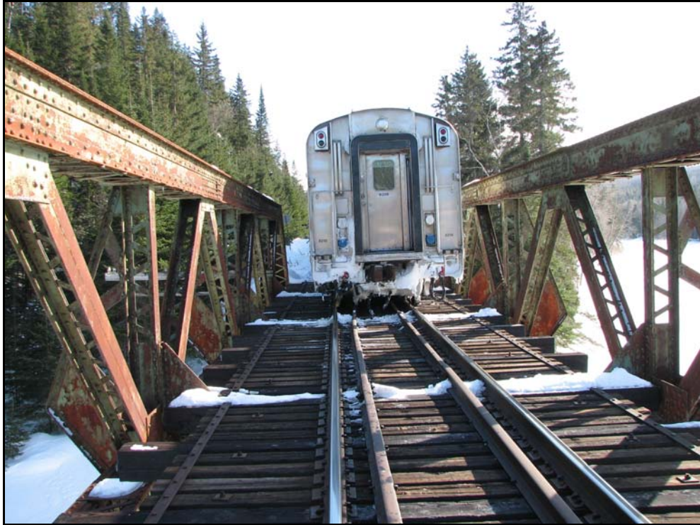
Photo 1. Voiture déraillée sur le pont enjambant la rivière Matapédia
