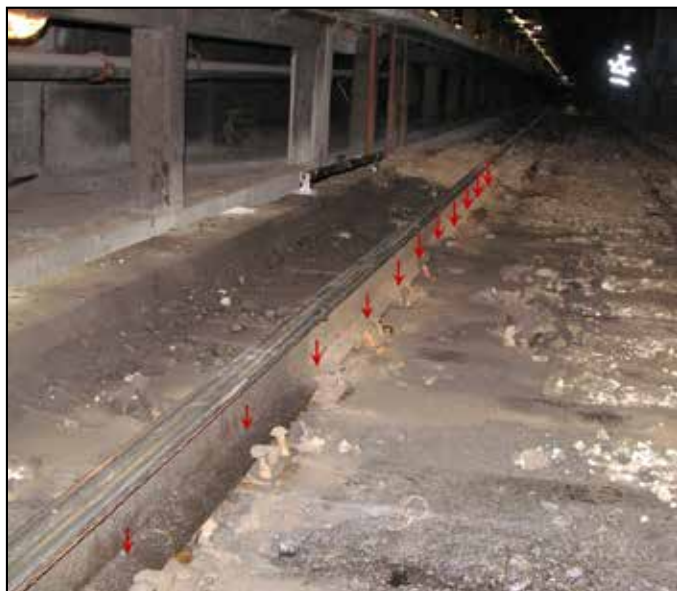
Photo 5. Les flèches rouges indiquent l'emplacement des selles de rail de 10 pouces fixées par des crampons à section arrondie à la fin de la courbe – rail sud
