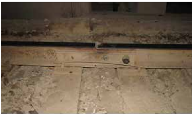
Photo 4. État du ballast
