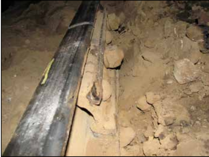
Photo 2. Marques sur un joint du rail sud
