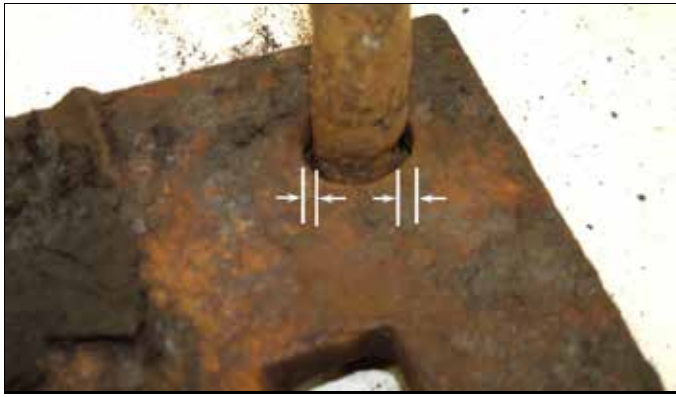
Photo 11. Agrandissement d'un trou de crampon dans une selle de rail atteignant jusqu'à \frac{1}{4} de pouce
