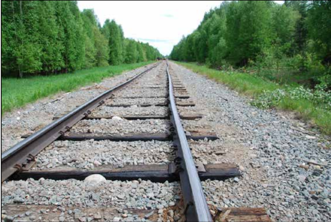
Photo 5. État du ballast et des anticheminants en amont du lieu du déraillement
