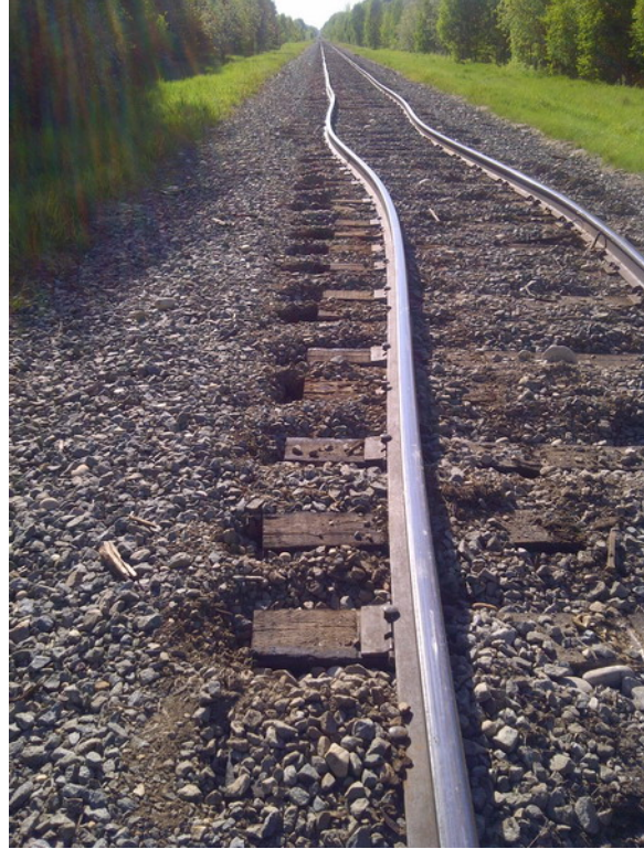
Photo 2. Vue vers l'ouest montrant le déplacement de la voie dans le ballast, qui a formé des écarts pouvant atteindre 12 pouces entre l'extrémité des traverses et l'épaulement du ballast
