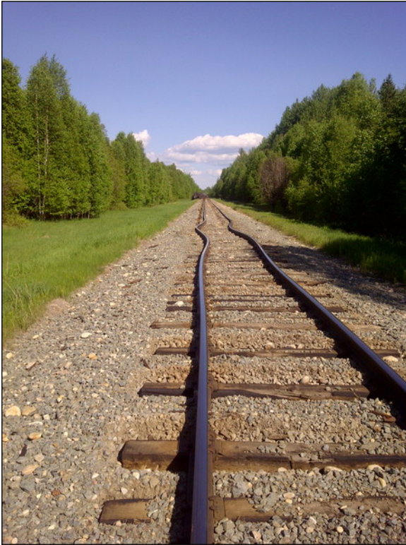
Photo 1. Vue vers l'est montrant le flambage de la voie (le nord est à gauche)
