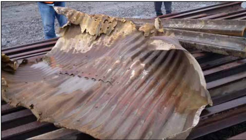
Photo 8. Section du ponceau corrodée et rouillée de part en part
