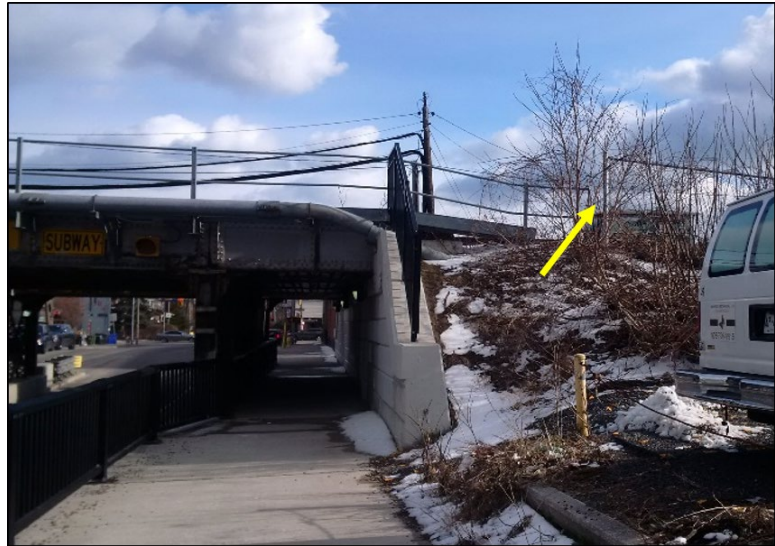
Figure 4. Ouverture dans la clôture au saut-de-mouton de l'avenue Howland, par où les adolescentes ont eu accès à l'emprise ferroviaire (Source : BST)
