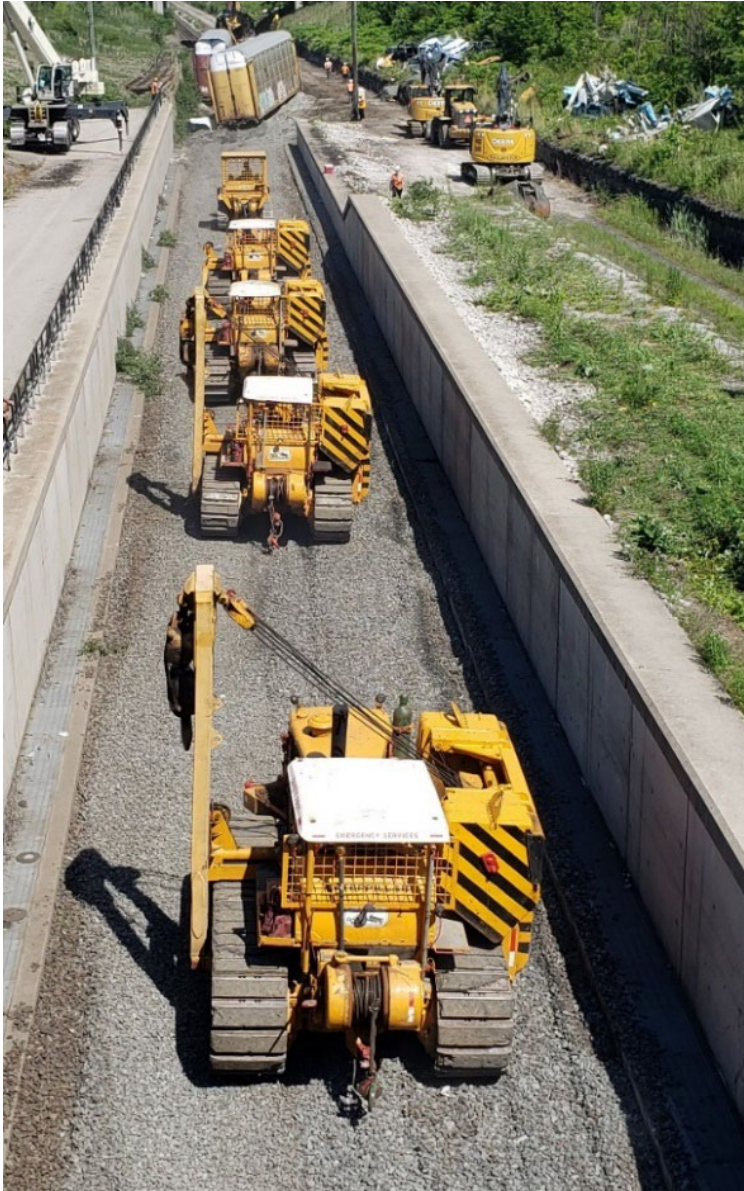
Figure 18. Équipement lourd utilisé dans le cadre des travaux de relevage (Source : BST)
